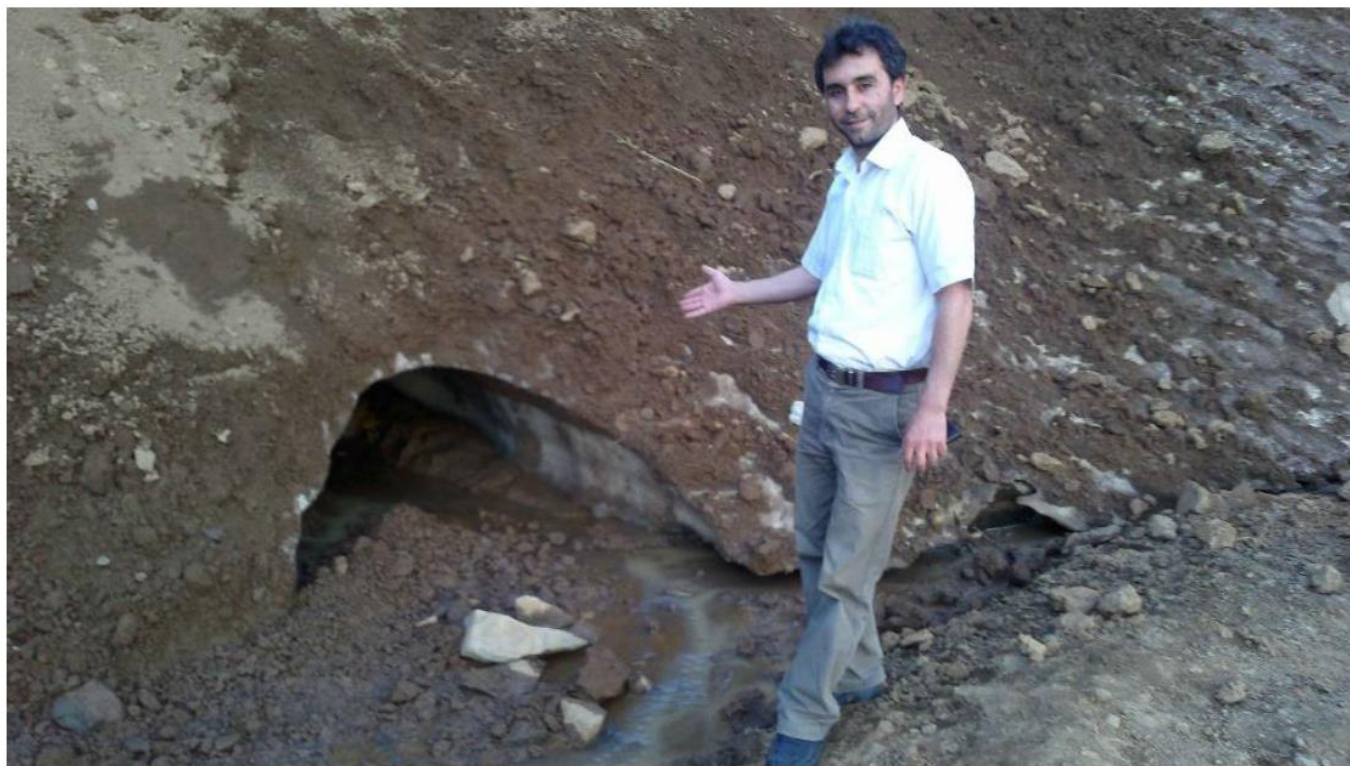
شکل ۱-۱- نمونه‌ای از کارست حرارتی در جاده پیست اسکی همدان
